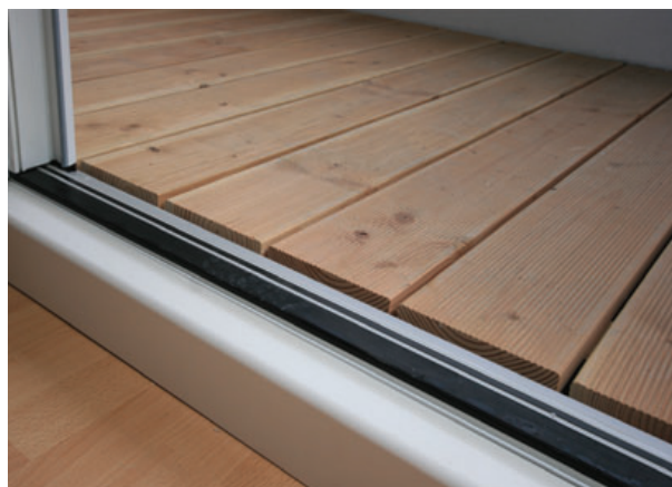
112 Einseitige Stufen statt beidseitiger Schwellen reduzieren die Stolpergefahr im Bestand; Märkisches Viertel, Gesobau Berlin
